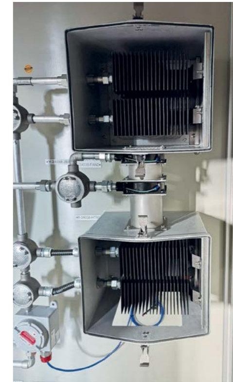
Redundante Ventilatoren mit Vorwärm-system.
