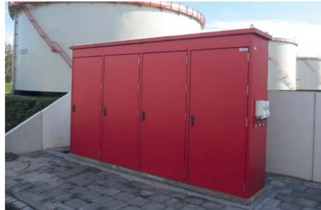
Schutzschrank für Ausrüstung zur Brandbekämpfung.
