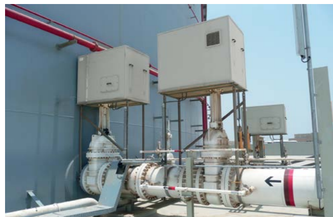
FIRE SHELTER zum Schutz der Antriebe für Notabschaltventile.
