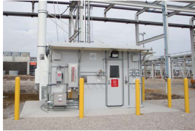
Schutzhaus für ein kontinuierliches Emissionsüberwachungssystem für einen Fackelkamin in einer chemischen Verarbeitungsanlage.
