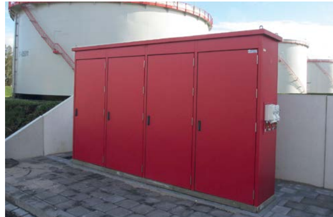
Schutzschrank für Ausrüstung zur Brandbekämpfung.
