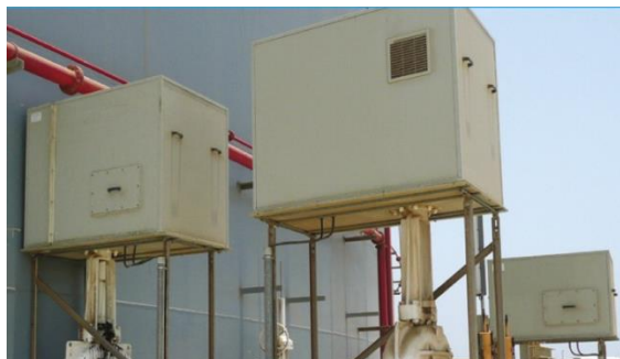
FireShelter на территории резервуарного парка
